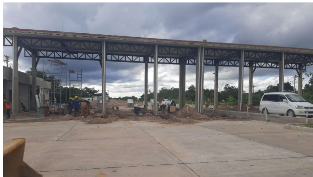
Obras Complementarias Tramo Doble Vía Yapacani - Puente Ichilo (Estac. de Peaje y Reposición de Servicios)
