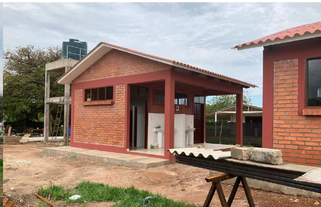
Batería de Baños
