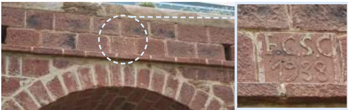
Figura 158 Procesos de erosión, laminación, meteorización y pulverización en la bóveda.
